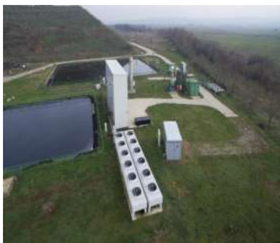
Figura VII.1.5.1. Instalația pentru valorificarea gazului de depozit și instalația de evaporare levigat de depozit deșeurilor nepericuloase de lângă celula I înverzită - incinta EcoBihor
